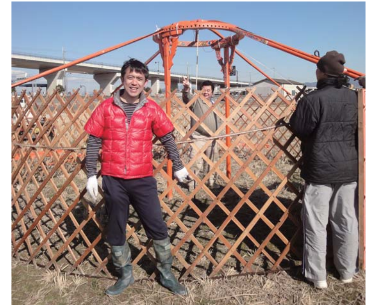
京都府宇治市での地域情報化プロジェクトにてゲル(モンゴルの伝統的な移動式住居)を設置中
